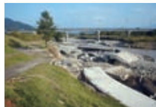
侵食による堤防被害状況
