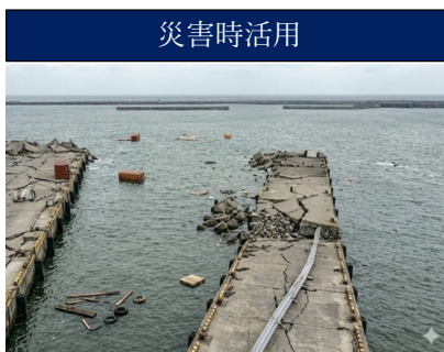
災害時活用 災害発生時の港湾係留施設の損傷状況や、沈没船の撮影など
