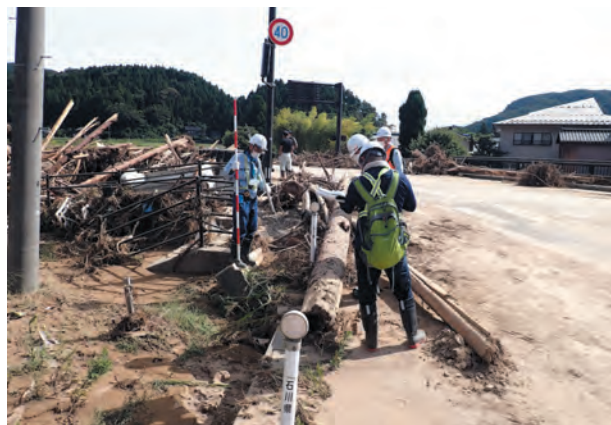
道路災害対応状況（豪雨災害後：新たな被災状況）
