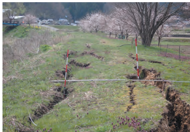
河川災害対応状況（地震災害後：堤防の亀裂状況）
