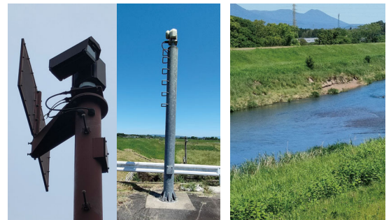
既設CCTVカメラ
