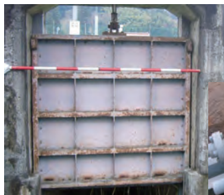
写真1 錆びが見受けられる扉体
