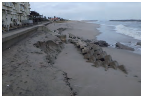
写真1 台風1919号襲来後の浜崖形成(皆生工区)
