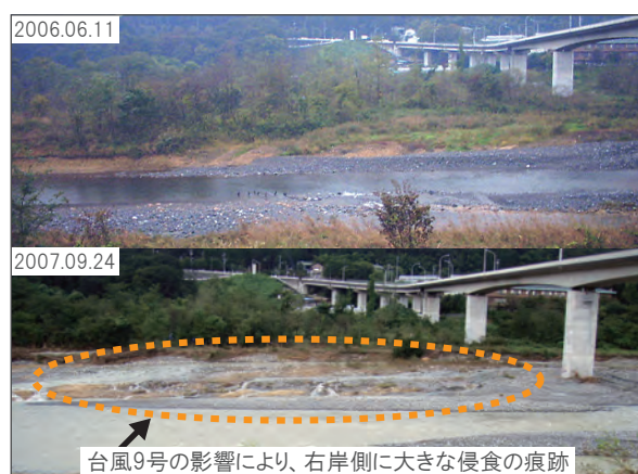
図3 多摩川羽村大橋下流右岸の状況
