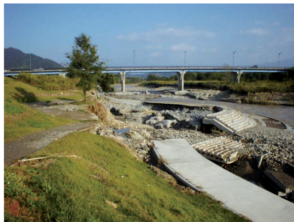
写真1 侵食による被害状況
