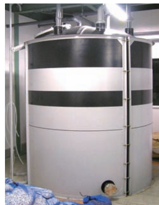
写真4 排水処理区画内タンク
